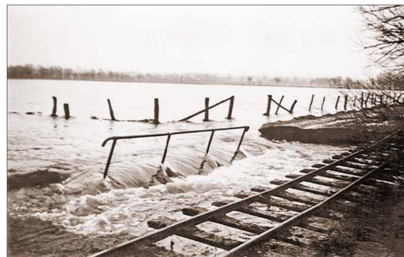
Reißende Fluten zerstörten 1941 die Pinnaubrücke. Die Gleise der Torfbahn hängen in der Luft
